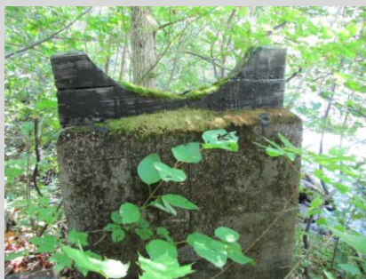
Support de conduite d'eau
