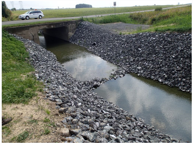
Bassins de sédimentation sur le ruisseau Janelle à Saint-Cyrille-de-Wendover (MTQ)
