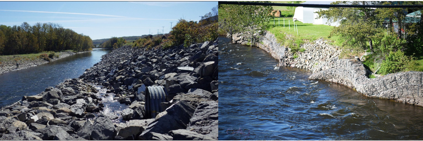
Problématiques suivantes les enrochements à Ste-Florence (Crédit photo: Mathieu Simard; Cinthia Gagnon )
