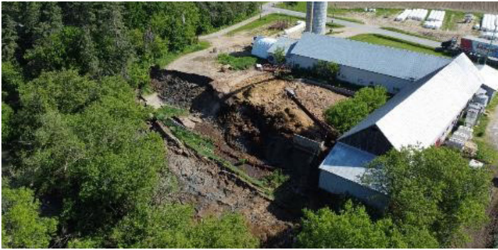
Figure 3.6 Exemple de glissement de terrain affectant l'intégrité d'un bâtiment agricole. © Ministère des Transports et de la Mobilité durable (MTMD)
