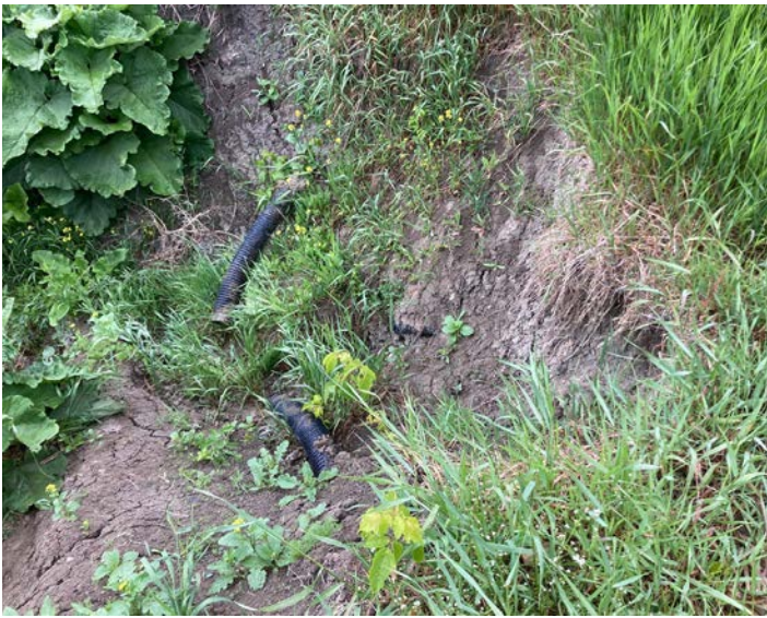
Figure 3.10 Problème d'érosion du talus d'une coulée agricole en raison de l'eau sortant des drains. © MAPAQ Mauricie
