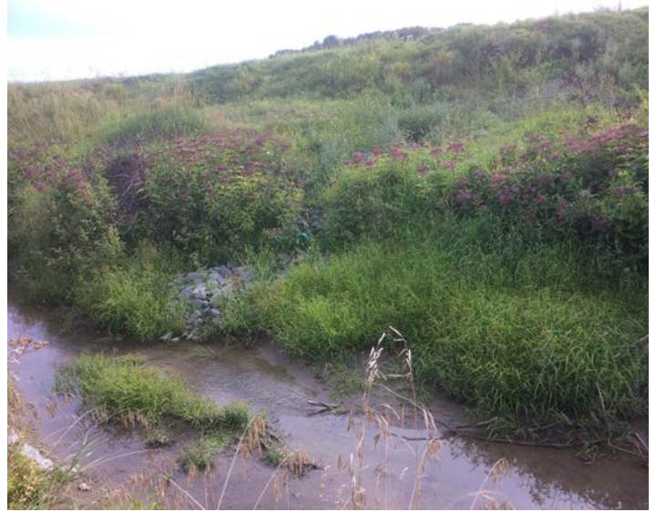
Figure 3.11 Sortie de drain aménagée et protégée en pied de talus. © MAPAQ Mauricie
