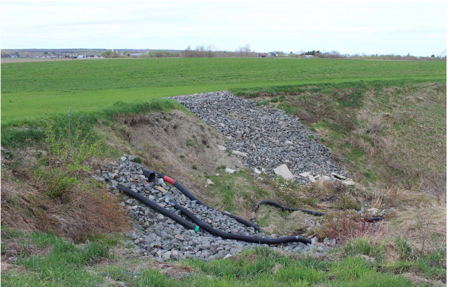
Figure 3.12 Sorties de drains rallongées jusqu'au pied de talus avec des tuyaux flexibles non perforés. © MAPAQ Mauricie
