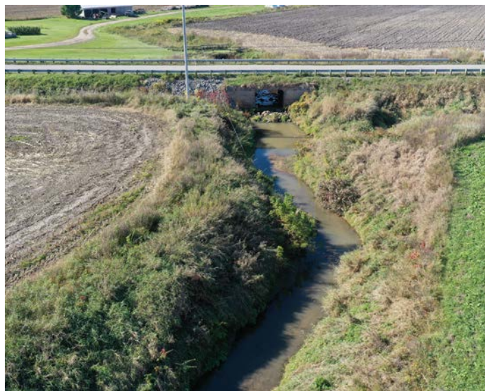
Figure 3.22 Radier de ponceau agissant comme un seuil. Notez l'abaissement du lit en aval de la structure. © Sylvio Demers
