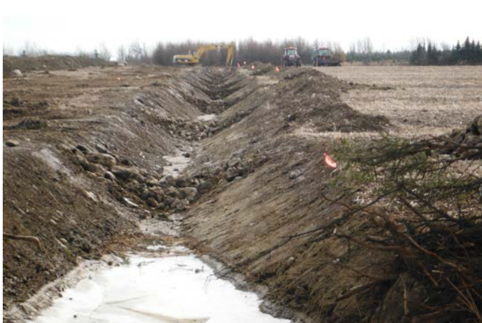
Figure 3.18 Seuils aménagés dans un fossé de drainage © Chloé Boucher-Ravenhorst
