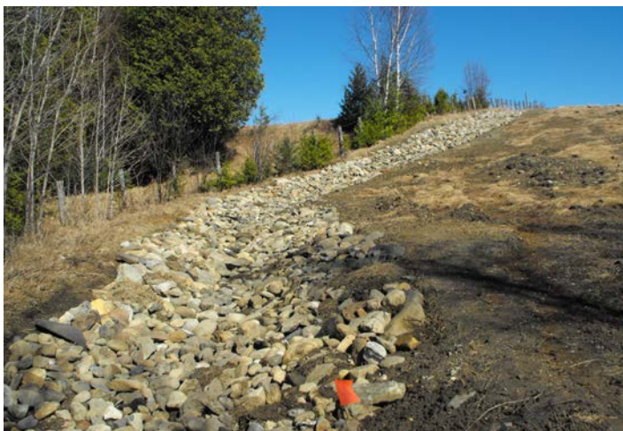
Figure 3.17 Enrochement de fond de fossé de drainage en pente forte. © Chloé Boucher-Ravenhorst
