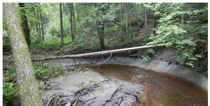
Figure 3.5 L'érosion en bas de talus peut déclencher un glissement de terrain. © Ministère des Transports et de la Mobilité durable (MTMD)
