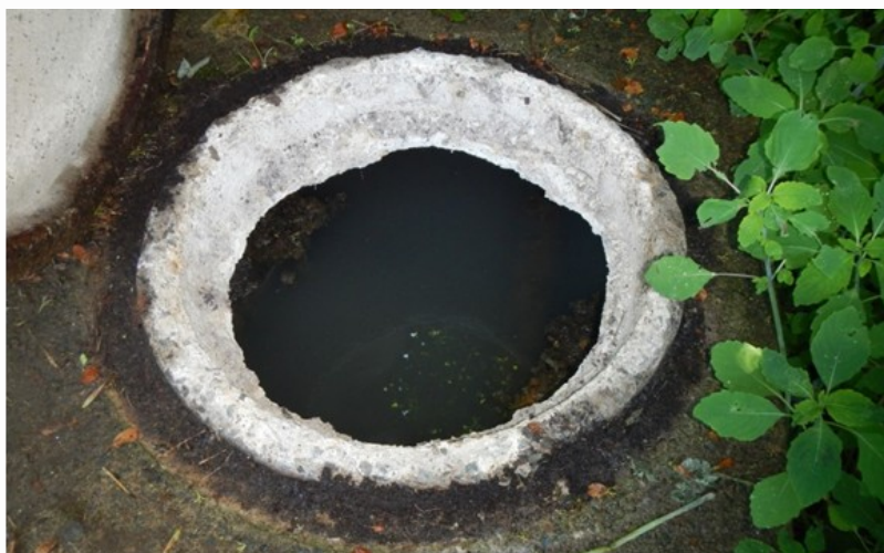
Inventaire de 229 fosses septiques pour 5 municipalités : Danville, Ham-Nord, Saint-Norbert-d'Arthabaska, Chesterville et Sainte-Séraphine
